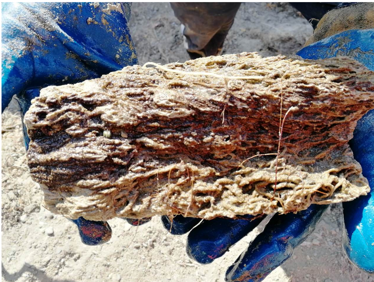
Рис. 2 – Фрагмент органо-минерального материала, из которого состоит засор трубчатого дренажа
